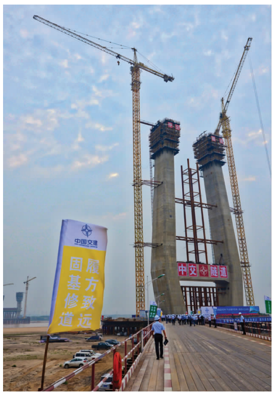
公司承建高门口黄河大桥为西北地区跨径最大的斜拉桥,入选国家第三批 PPP 财政示范项目,图为建设中的 12 号索塔。(王克印/摄影报道)
